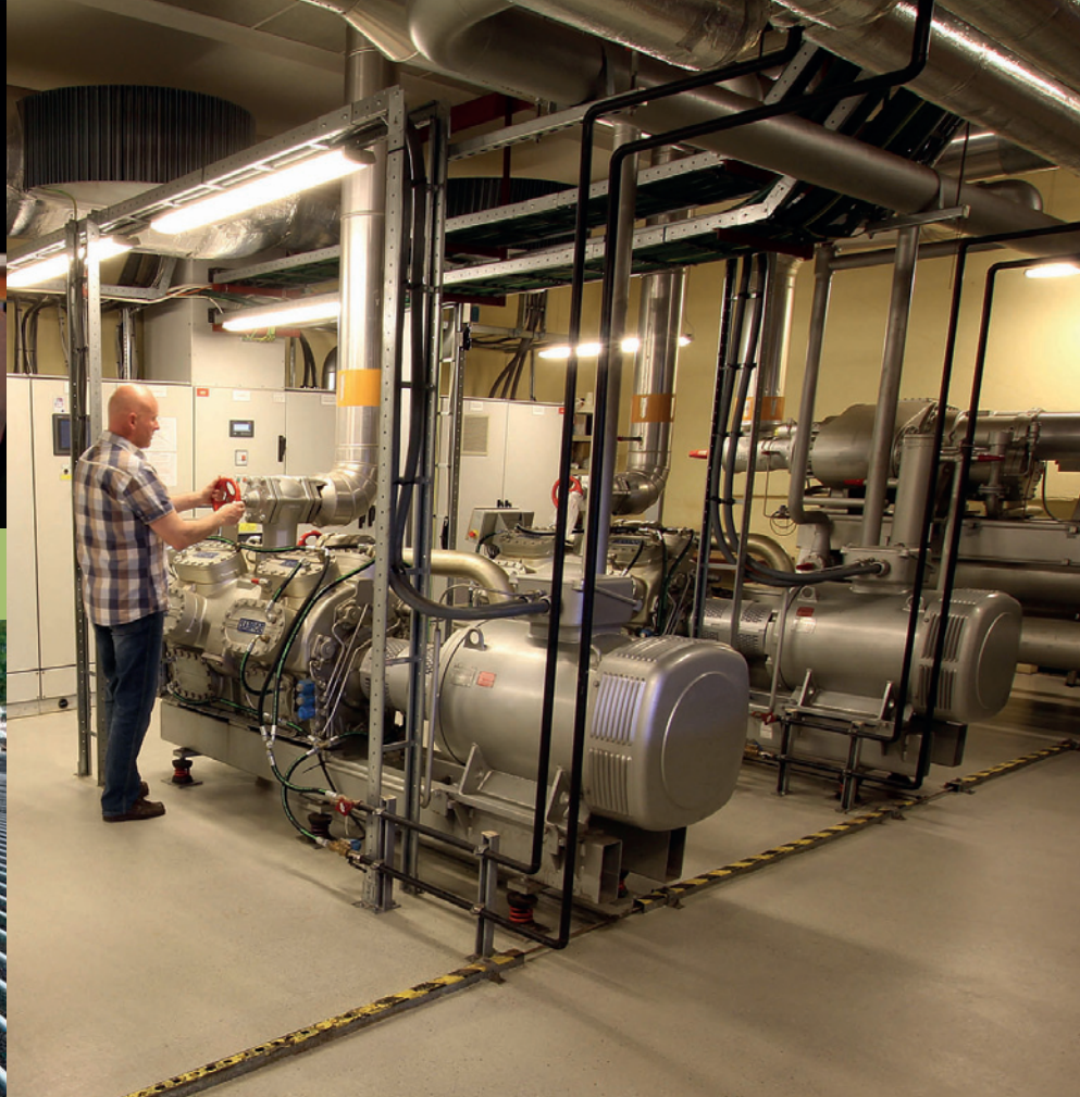
Teknisk sentral, Marienlyst nærvarmenett.
